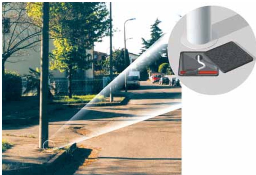
Rys. 5. Instalacja u podstawy słupa
